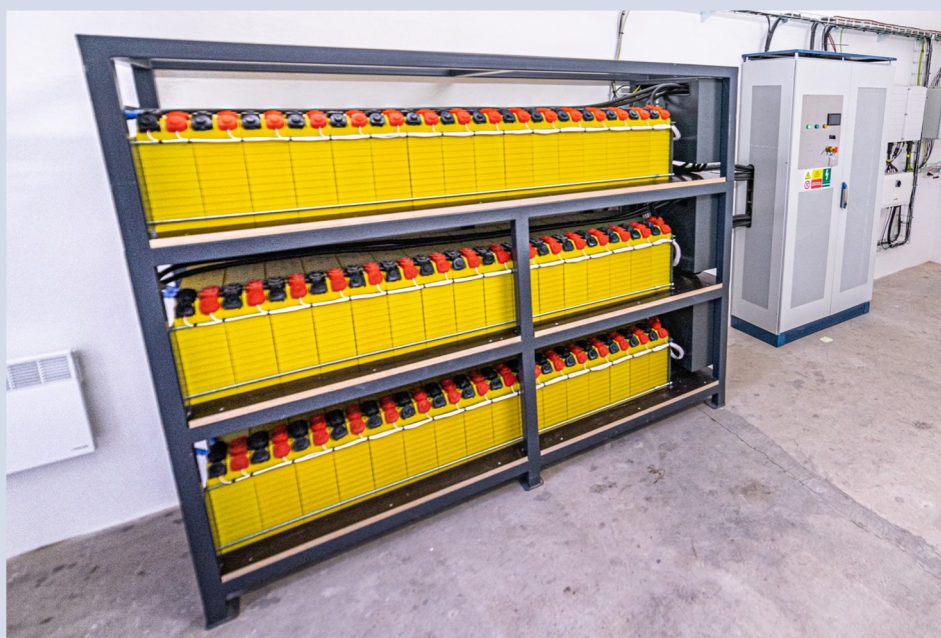
Obr.: 3x AMVOLT 50kWh Modul ve třech patrech nad sebou. 3x16 kusů LiFePO 4 článků Winston WB-LYP1000AHC 3.3 V, 1000 Ah s nominálním napětím 48 V, generální dodavatel instalace: ENERG-SERVIS a.s. + Tomáš Vocilka (Asolar s.r.o.)
