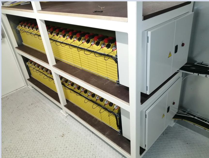
Obr.: 2x AMVOLT 50 kWh Modul (tedy 100 kWh) uvnitř AMVOLT LV Battery Containeru = 2x 16 kusů LiFePO 4 článků Winston 1000 Ah s nominálním napětím 48 V
